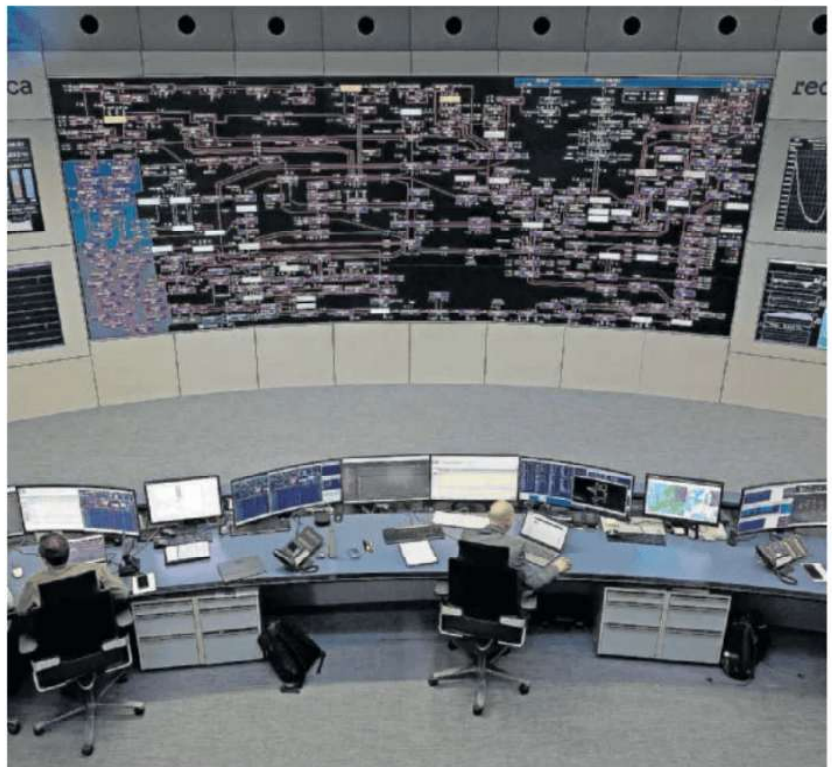
Vista del centro de control eléctrico de Red Eléctrica en Madrid, el día 20. MARISSAL (EFE)
